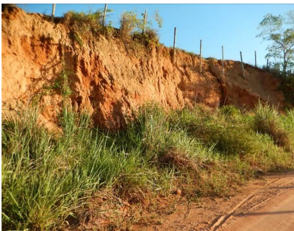
Talude de corte erodido
