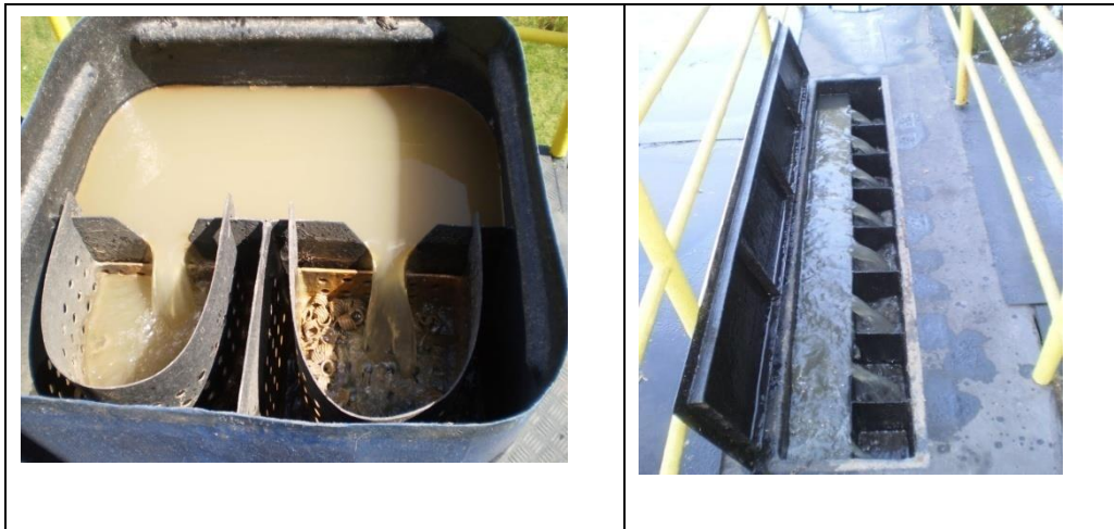
Figura 3 – Caixa de distribuição e de descida de esgoto bruto
