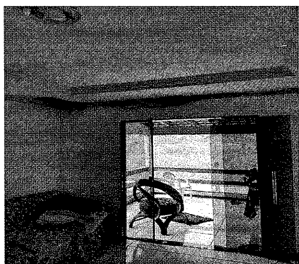
Sala com infiltração no telhado.
