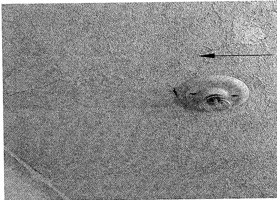
Trinca no teto.
