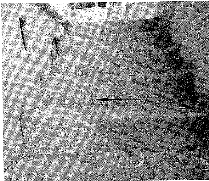
Trinca na escada de acesso.
