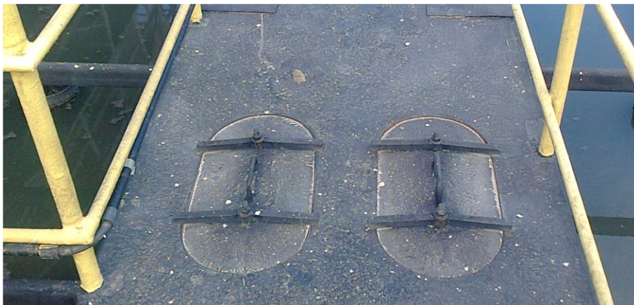
Figura 4 – Tampa da boca de visita da câmara de gás
